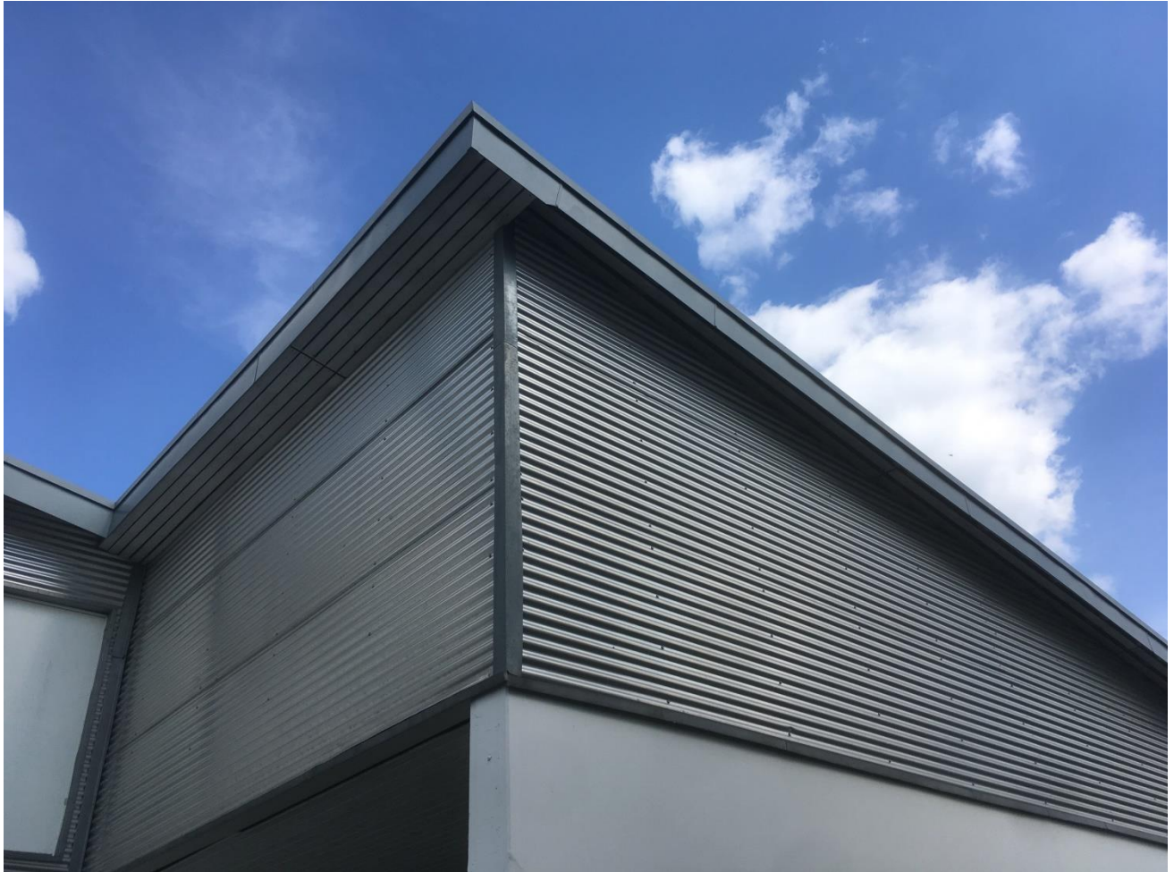
Abbildung 2: Foto vom Dachüberstand im Bereich der bestehenden Anlieferungsrampe; Quelle: Eigenes Foto, aufgenommen am 14.05.2019
